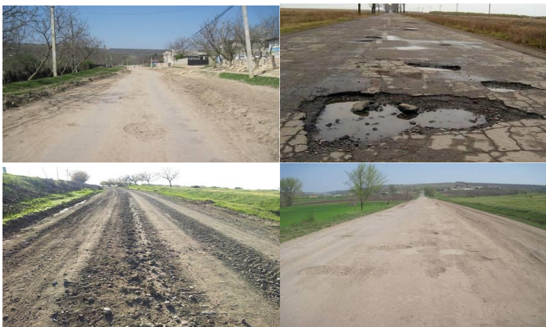
Figura 2-10: Degradări ale drumurilor locale
