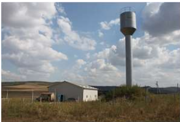
Stația de tratare și turnul de apă potabilă construite în cadrul proiectului, anul 2014
